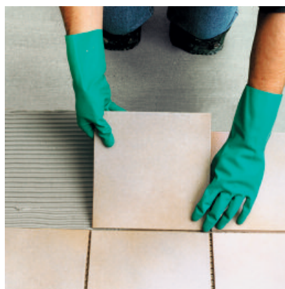
5. der Entkopplungsplatte PCI Polysilent oder den PCI Pecilastic Bahnen überarbeitet werden. Auf dieser Abdichtungs- bzw. Entkopplungsschicht können nach deren Trocknung Fliesen und Platten verlegt werden (siehe Tabelle).
